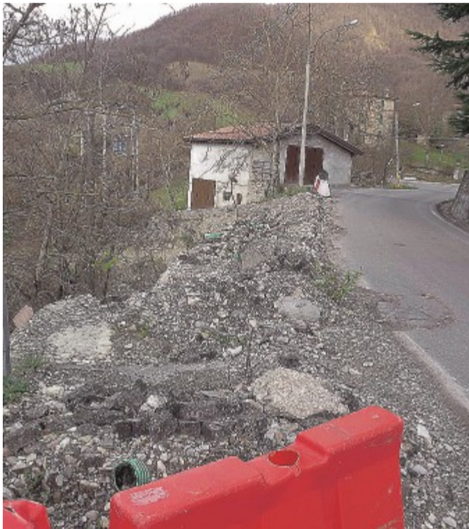
Ruzzano La frana che minaccia la strada provinciale.
